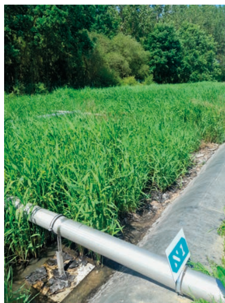
Filtre planté de roseaux – cœur du traitement
